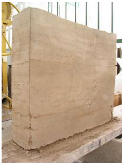
Foto 8.4.s: Grietas en la tapia estabilizada con cemento y cal
