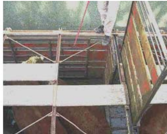
Foto 19: falta tabla en el techo de la jaula
